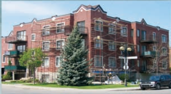
SYNDICAT COPROPRIÉTÉ DU 3478 WILLIAM TREMBLAY Réparations d'importantes infiltrations d'eau au dessus plusieurs fenêtres et à la base des murs de briques
