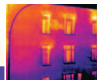
Détection d'eau mur de briques
