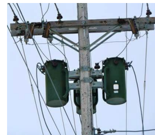
Transformateur sur poteau
