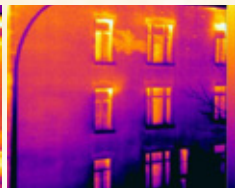
Détection d'eau mur de brique
