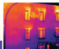
Détection d'eau mur de briques
